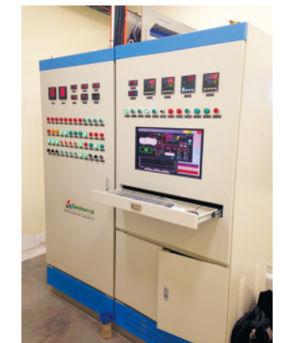
远程检测控制系统 Remote monitoring control system
